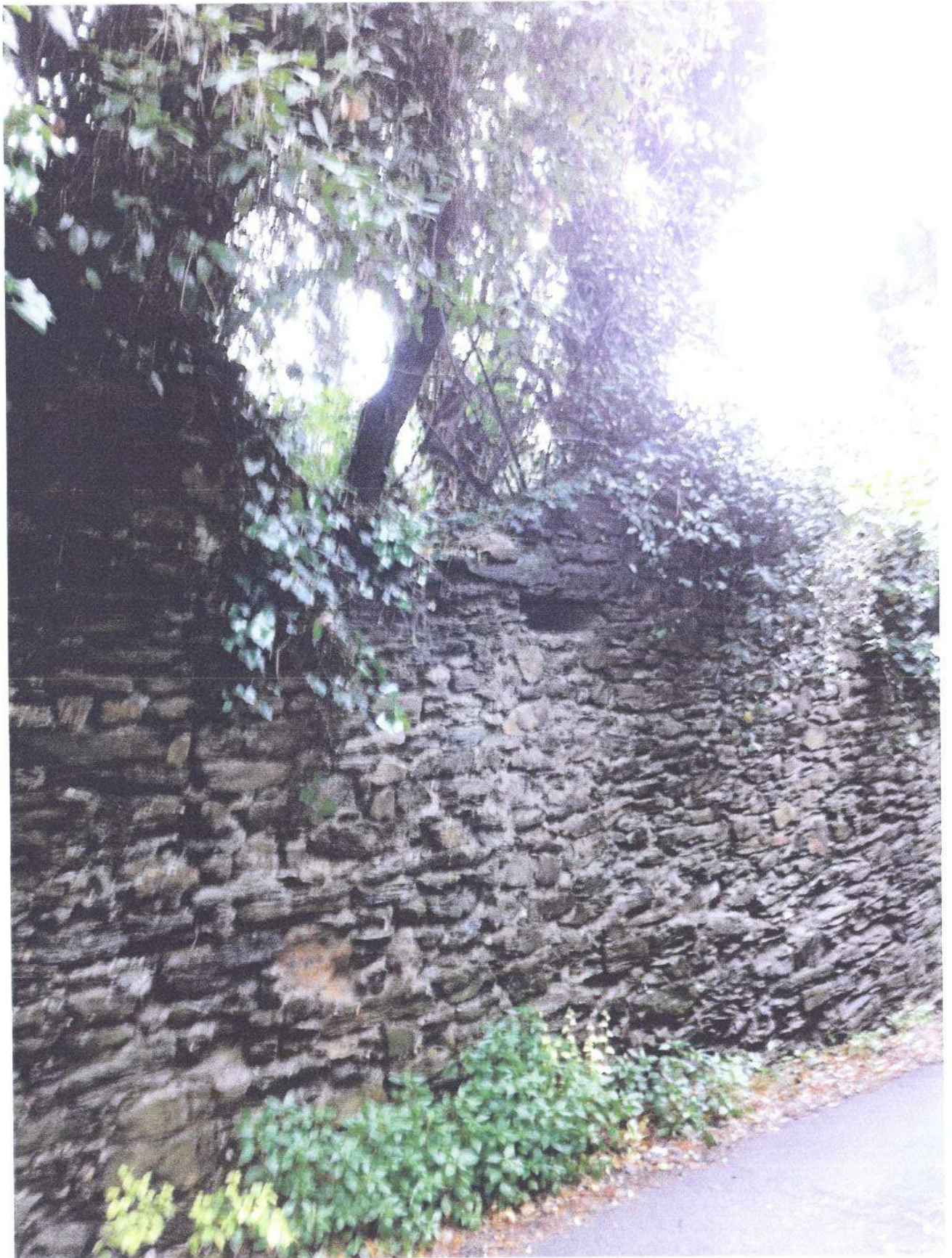
FOTO 8: Altra breccia nelle murature creatasi nella parte alta della Proprietà
