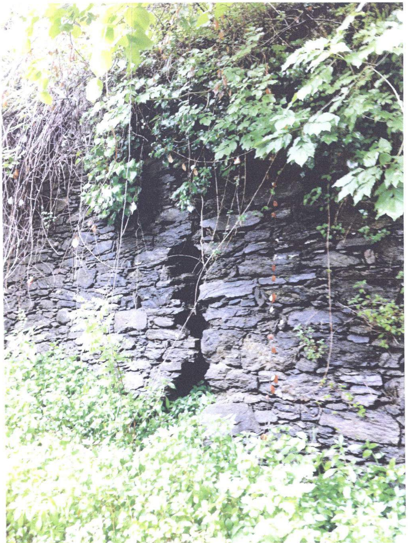
FOTO 5: Terza grande lesione che ha interrotto la muratura per tutta la sua altezza
