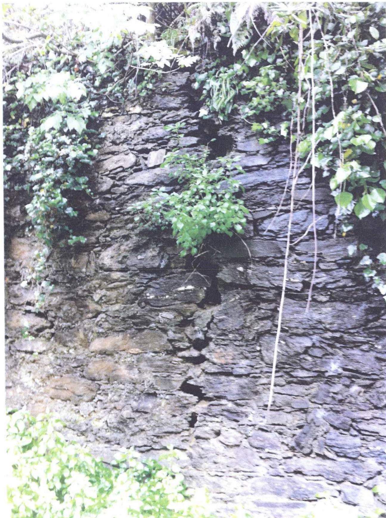
FOTO 4: Seconda grande lesione che ha interrotto la muratura per tutta la sua altezza
