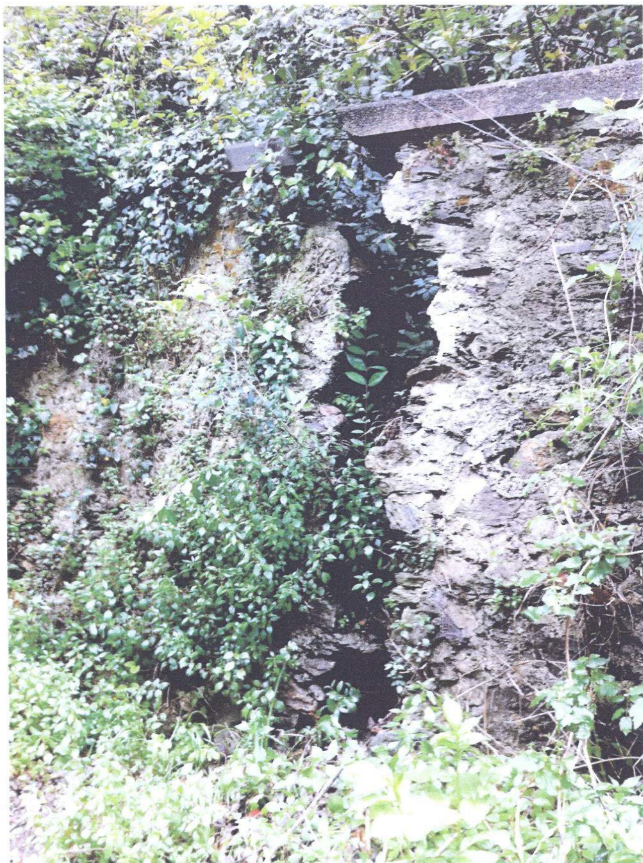
FOTO 3: Prima grande lesione che ha interrotto la muratura per tutta la sua altezza
