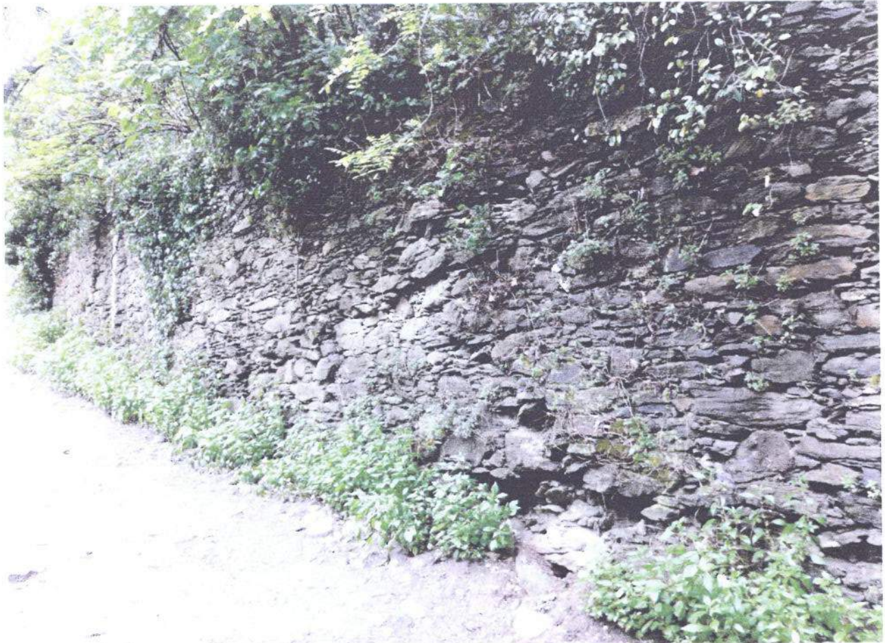
FOTO 1: Lesioni nella muratura che ne minacciano la stabilità
