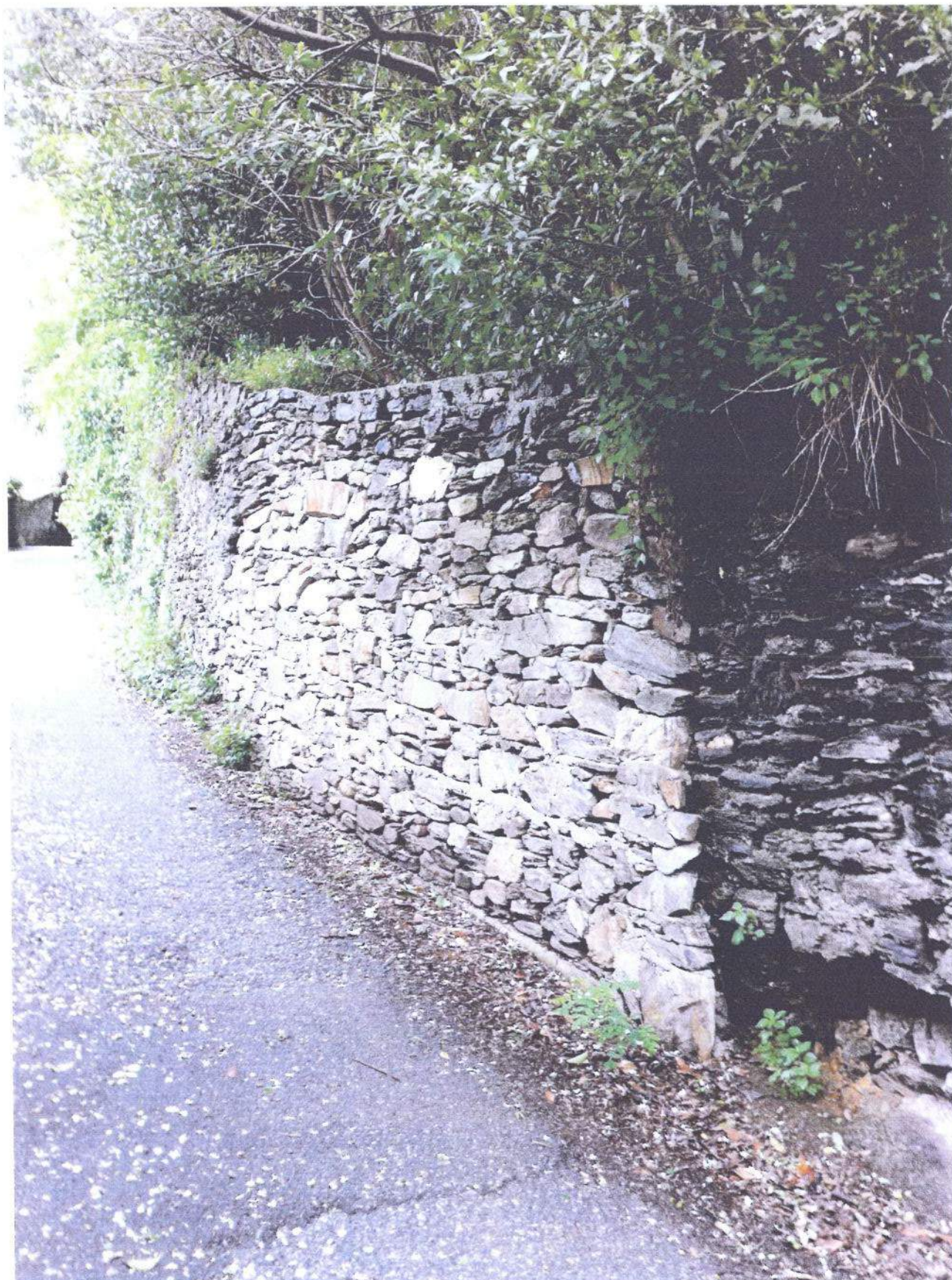
FOTO 7: Tratto recentemente ricostruito da INRCA nel quale compare comunque in adiacenza un muro lesionato alla sua base
