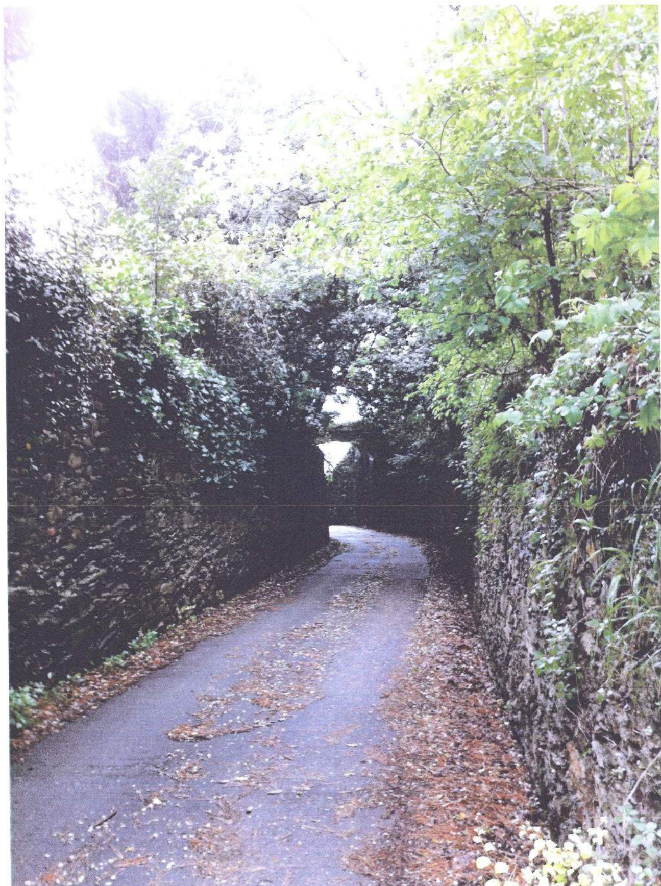
FOTO 9: Tratto di muri ancora in buono stato nella parte alta della Proprietà
