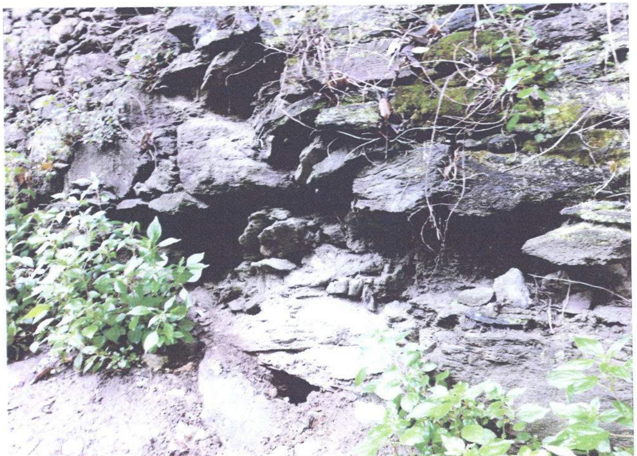
FOTO 2: Lesioni nella muratura che ne minacciano la stabilità - Particolare
